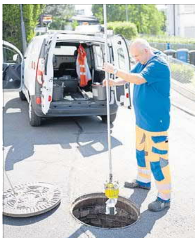
Frank Auth vom Abwasserverband Fulda kontrolliert eine Falle, die in der Kanalisation in Horas eingebaut ist. Foto: Jonas Wenzel
